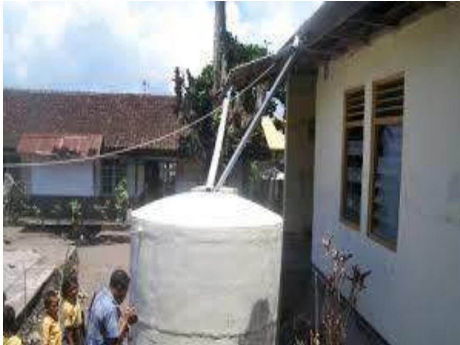
Gambar 1.27 : Penampungan Air Hujan
