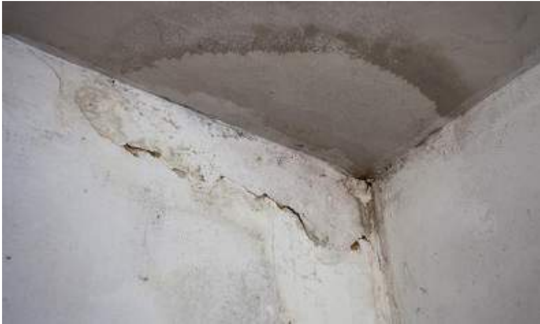
Gambar 3.6: Atap Bocor Faktor Risiko Terjadi Kelembaban tinggi
