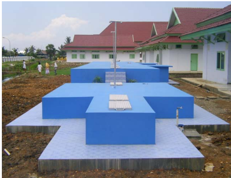
Gambar 3.25 : IPAL Biofilter Anaerob-Aerob Bentuk Dari Bahan Beton Bertulang. (Lokasi : RSUD Pangkep, Sulawesi Selatan)
