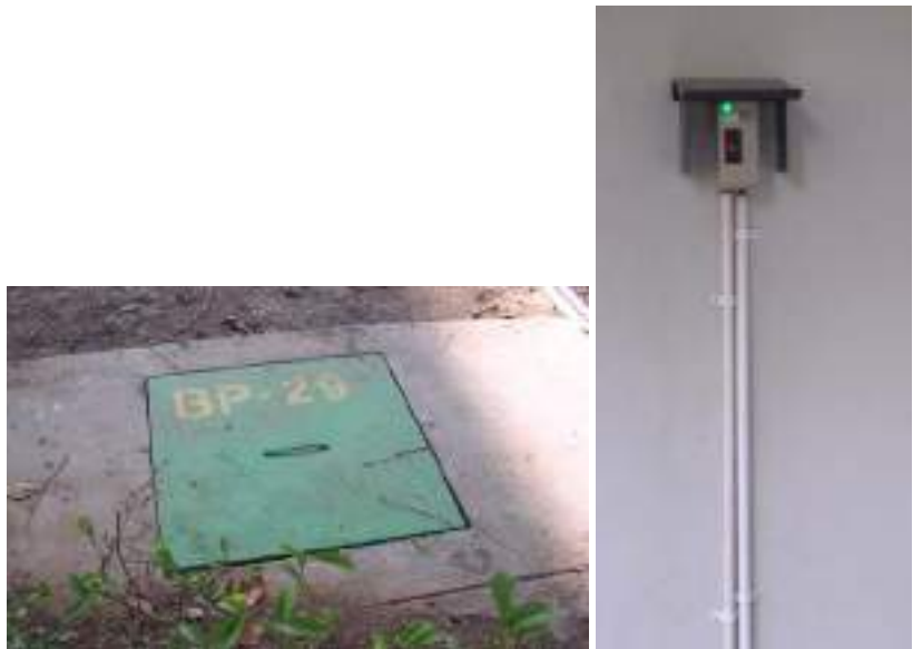
Gambar 3.5 : Bak Pengumpul Air Limbah (Tampak dari Atas) dan Panel Kontrol Pompa.
