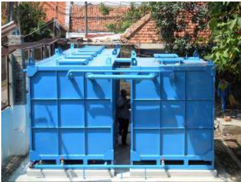
Gambar 3.24 : IPAL Biofilter Anaerob-Aerob Yang Dibuat Dari Bahan Plat Baja Yang Dilapisi Dengan Bahan Anti Karat. (Lokasi : Rumah Bersalin St. Yusuf - Tanjung Priuk - Jakarta Utara )
